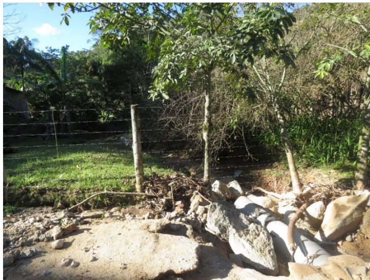
Erosão estrada/Rua Paulo Dallago
