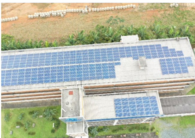
Usina fotovoltaica Campus Piçarras
